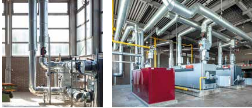
Das Areal des Polizeipräsidiums Einsatz in Bruchsal wird umweltschonend und effizient mit Wärme aus Tiefen-Geothermie und einem BHKW versorgt.
